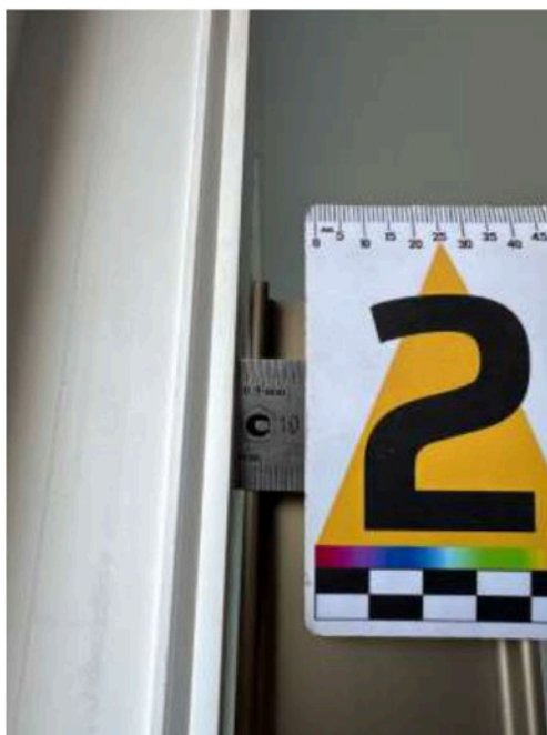
Фото № 10. Деформация профиля оконной створки №1
